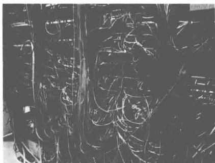
图 10-2 相互纠缠的机房布线
